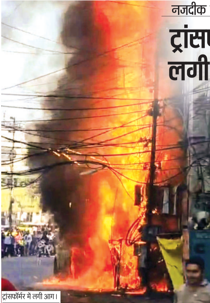
ट्रांसफार्मर में लगी आग।
